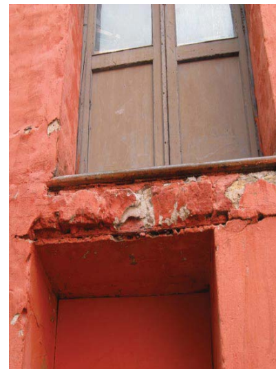
Misfarvning og øget pudsafskalning ved sokkel
