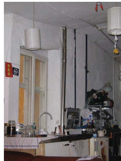
Skævheden opleves fint på dette billede. Som det ses falder loftet ca. 1/2 meter.
