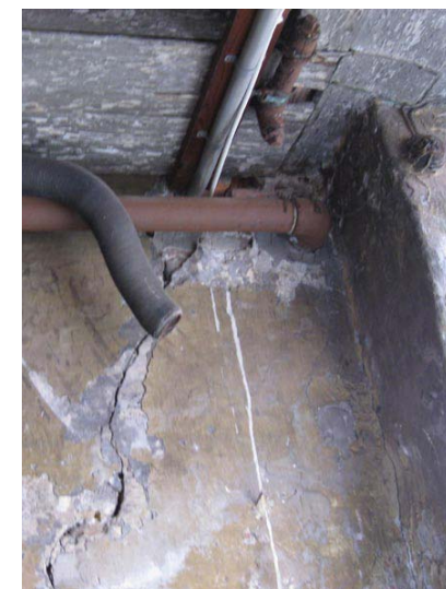
Hovedgasledning murgennemføring fra forhuset
