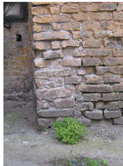
Sætning i fundering sydvestlige hjørne af byg 5.
