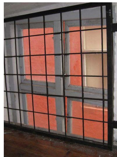
I mellemreposerne er der placeret et gitter foran vinduerne. Er ikke fæstnet
