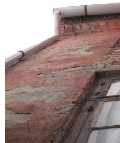
Afskalning af maling. Dybe fuger i murværk. Gesims beskadiget.
