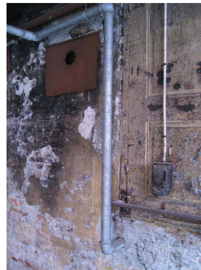
Hovedvandledding fra forhuset, bygning 1
