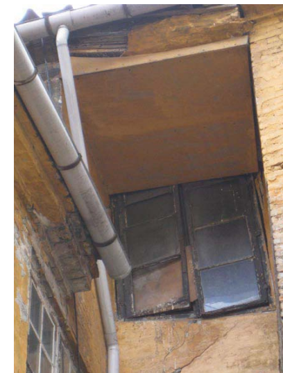
Øverste vindue i det tilbagetrukne fag falder med 18 cm pr. meter. Ødelagt gesims.
