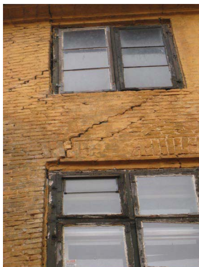
Sætningsrevner i murværk
