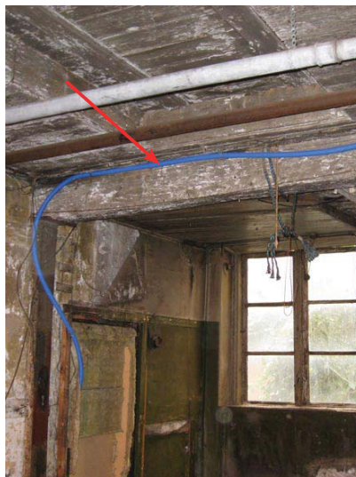
Pex rør ført gennem værksted (stueetage, bygning 2) til baderum
