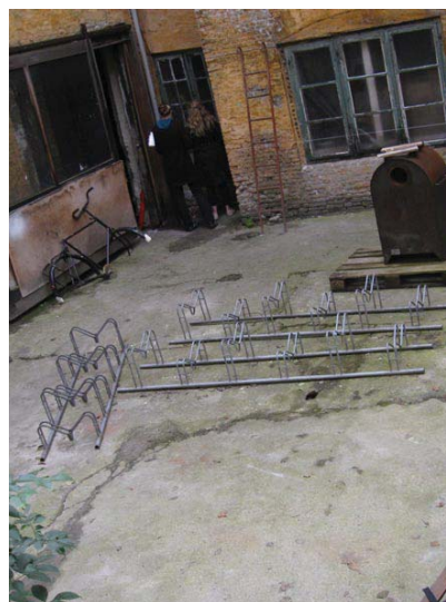
Lille gård. Lang revne i asfalt
