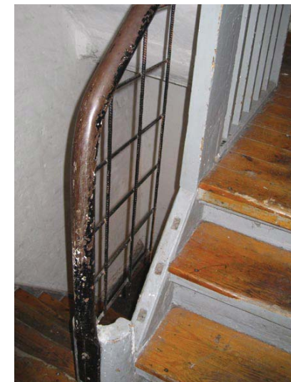
Træ-rækværket blevet skiftet ud med balustre og håndliste i jern. Dårlig fæstning
