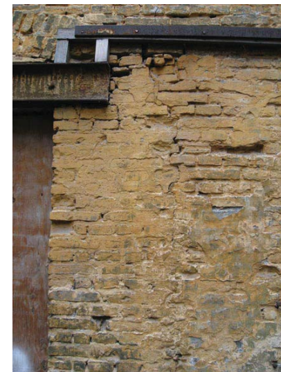
Port 2: Forvitrede og revnede mursten omkring det indlagte I-profil
