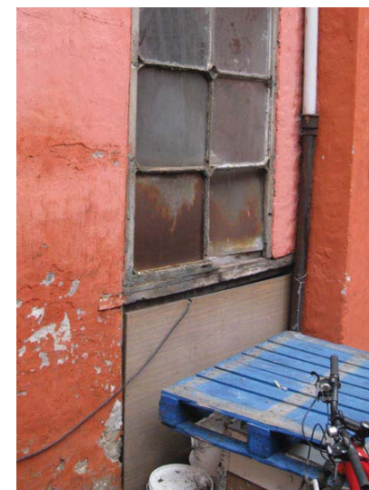
Murværk mangler, er udfyldt med træplade
