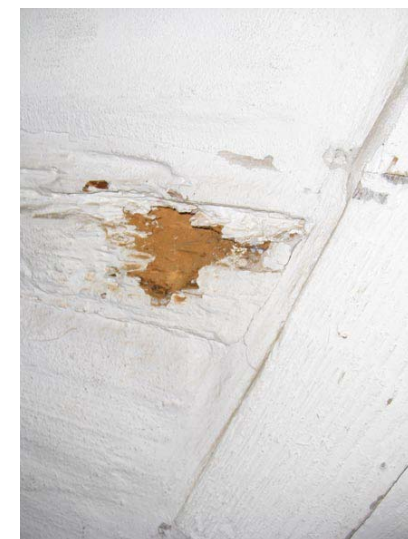
Fugtskade på træ i bindingsværk. Formentlig fra fugtnedsivning fra manglende skotrende på tag
