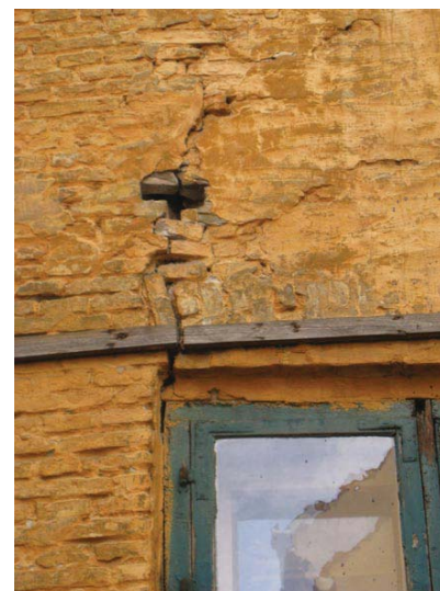
Sætningsrevner og manglende/forvitrede teglsten
