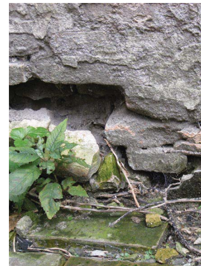
Sætning i fundering set fra lille gård i byg 5.
