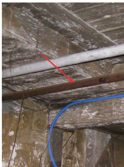
Hovedgasledning under loft stueetage byg 2.
