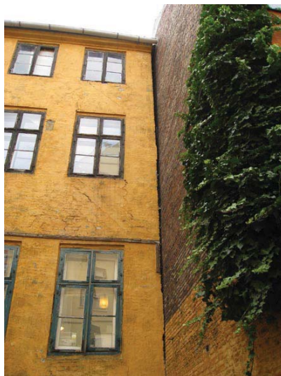
Bygning 5. Husets sætning ses her i forhold til gavl på nabohus. Gaber ca. 20 cm ved tagfod.
