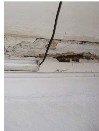
Bygning 2, 1.sal. Skade i loft
