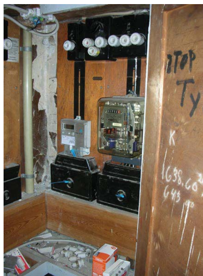
Målerskab og gruppetavle i opgang 2. sal byg 2.
