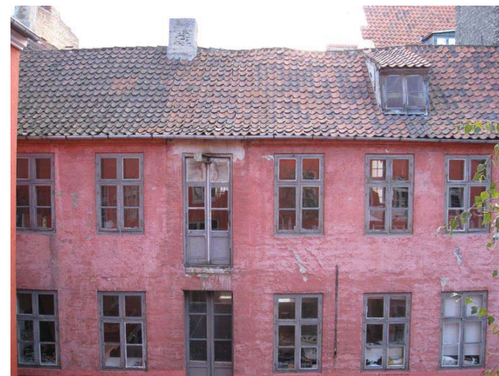
Bygningens tag set fra gårdside - voldsomme bølger pga. nedsunkne spærender
