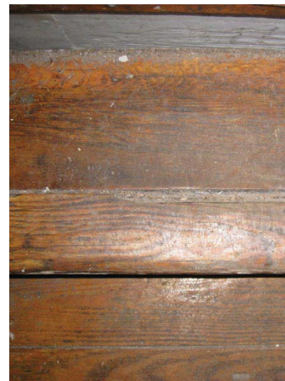
Lakerede trappetrin. Revne og slitage
