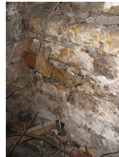
Bagmur, værksted. Fugtoptrængning i nederste del af murværk.
