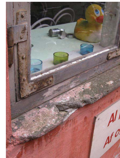
Afskalning af maling. Dybe fuger i murværk. Gesims beskadiget.
