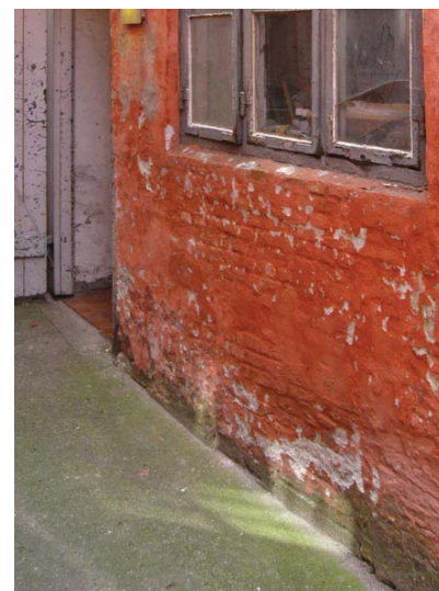
Misfarvning og øget pudsafskalning ved sokkel
