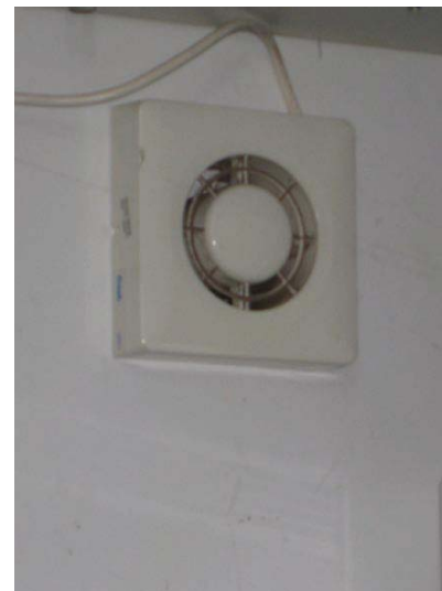
Ventilation i baderum bag fælles møderum i bygning 2. udsugning
